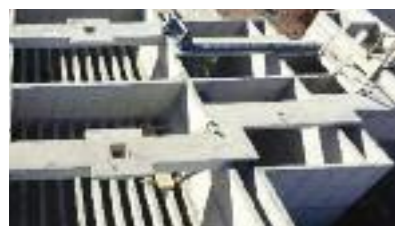
Floculateurs et décanteurs.
