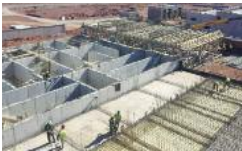
Radiers des filtres et chicanes des citernes eau traitée.
