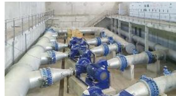
Station de pompage d'eau brute.
