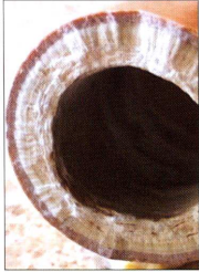
Photo 1 - Dépôts de tartre dans une canalisation
